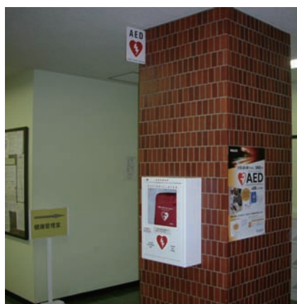
診療所（つくばセンター）に設置されたAED
