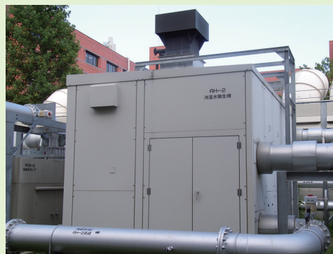
熱源供給施設のリニューアルにより つくば中央第5事業所に設置された冷温水発生機のボイラー部分
