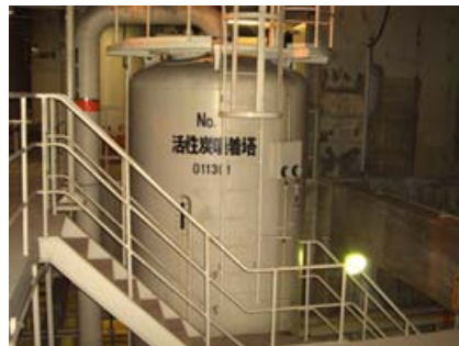
処理プロセス中の活性炭吸着塔
