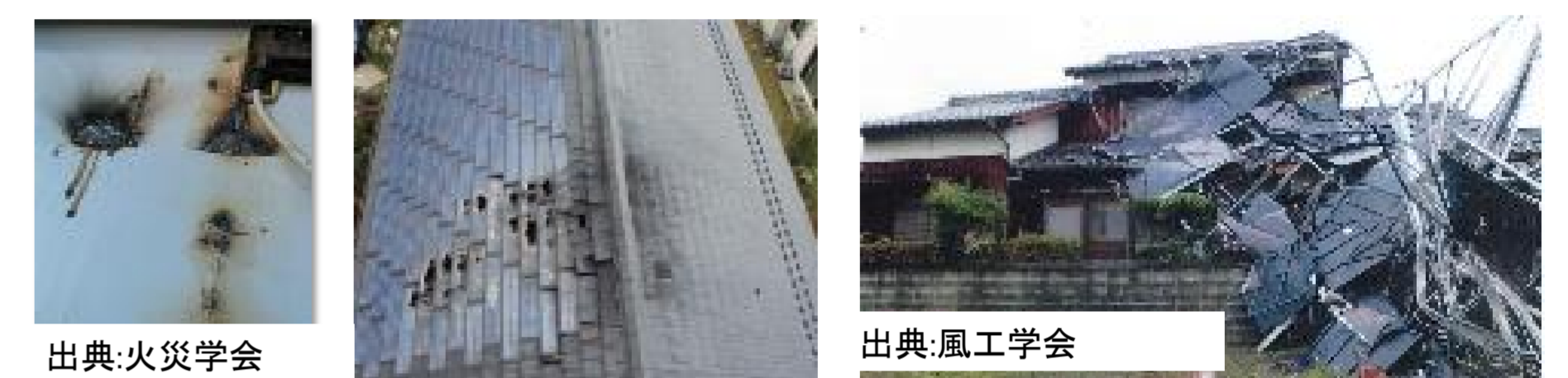
図 太陽光発電の事故事例(火災、構造物飛散)
