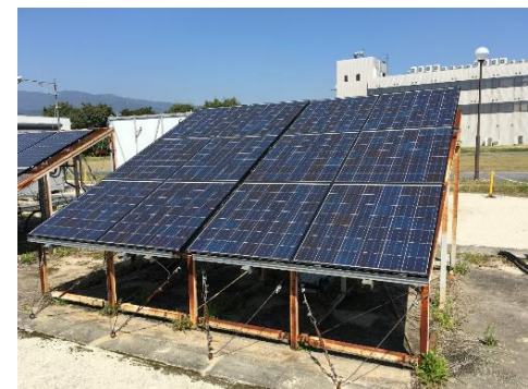
屋外設置モジュール・ストリング
