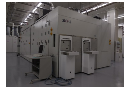
イオン注入装置
