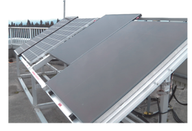
Fig. 1, トヨタ車体研究所屋上における屋外暴露
