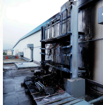
図2 国内PVシステムの接続箱火災
