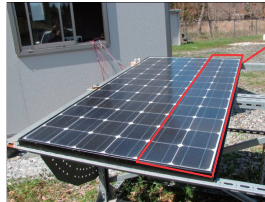
PVモジュール写真
