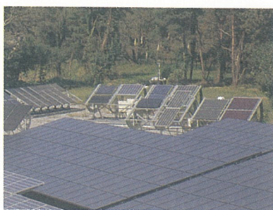
産総研に設置されたモジュール屋外試験サイト
