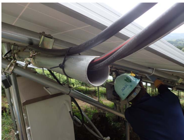
図 4.R3.5-14 ケーブル配線の状況
