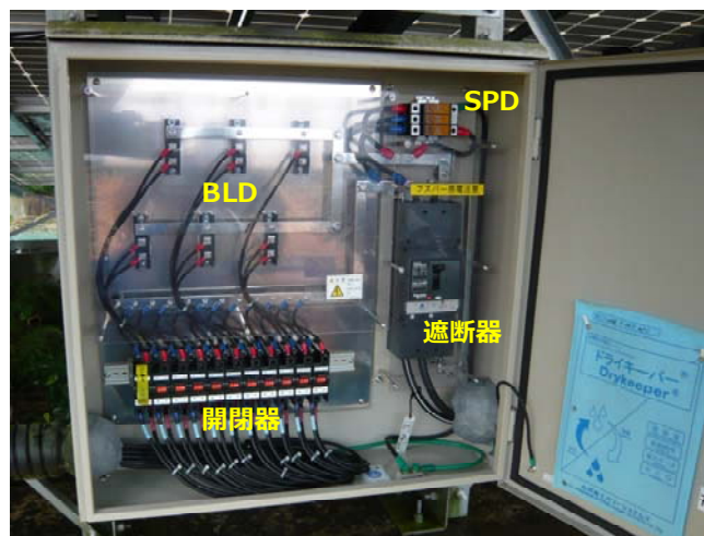
図 4.R2-5 接続箱内部の様子
