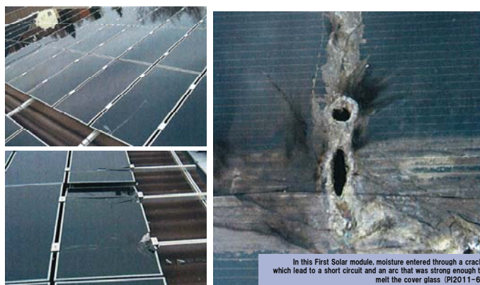
図 3.2.1-1 積雪荷重によるガラス割れによるモジュールアーク事例
