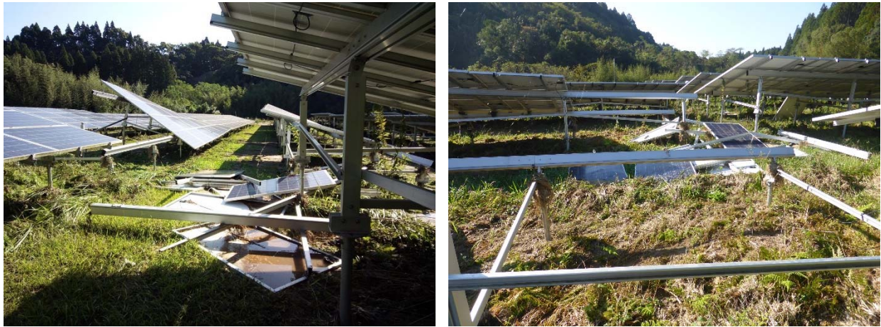
図 4.R3.3-21 水没による外観的な被害の様子(接続箱#02 付近)
