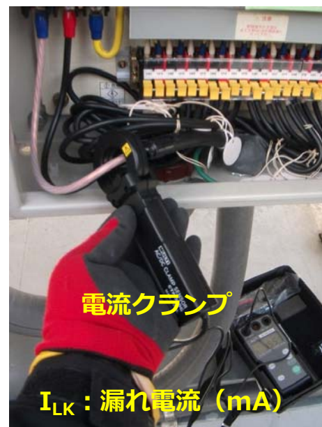
(c)漏れ電流の測定
