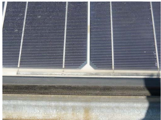
図 4.R3.10-4 絶縁不良が疑われるモジュールのバスバー部
