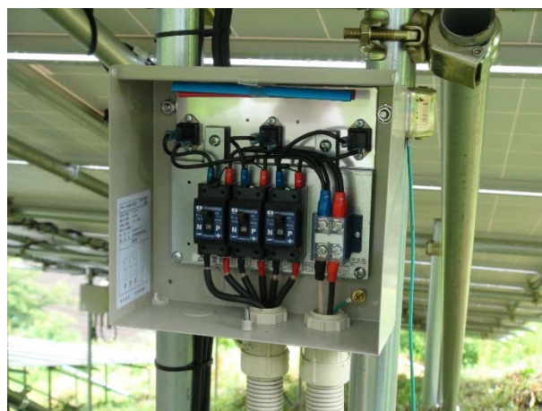
図 4.R3.5-1 接続箱内部の様子
