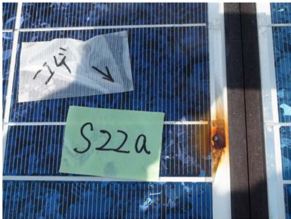
(a)横タブの接続部の導通不良に起因する褐色変
