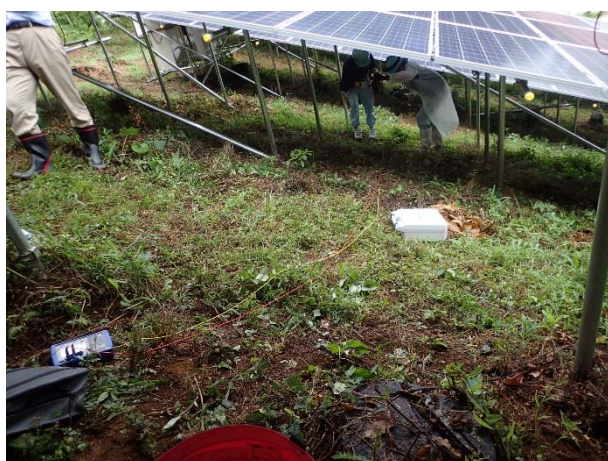
図 4.R3.5-3 接地抵抗測定の様子
