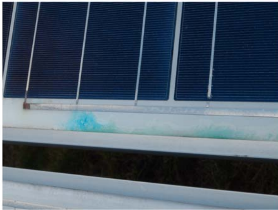
(a)モジュール周縁部の変色
