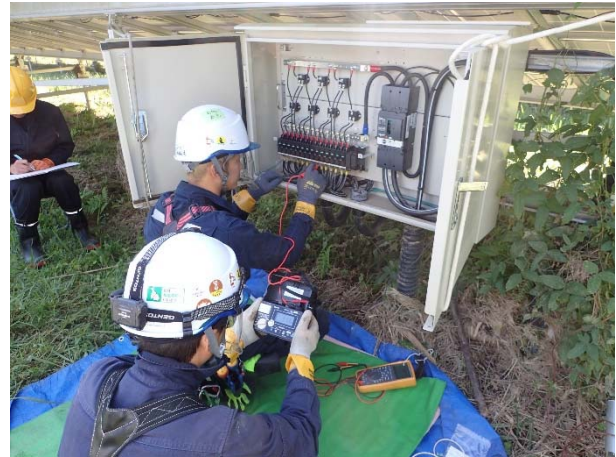
図 4.R3.3-13 絶縁抵抗を測定している様子
