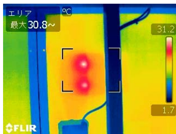
図 4.R2-28 インターコネクタ—セル間の接続不良による発熱の例
