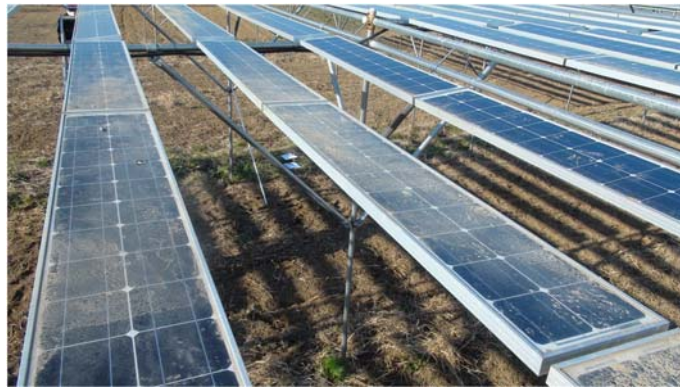
図 4.R3.11-8 P2-1 スtringを構成するモジュールの表面の汚れ
