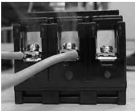
(a)交流用開閉器使用による短絡電流開放時のアーク
