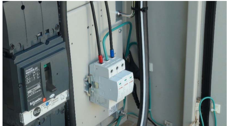
図 4.R3.3-7 接続箱内の接地極(接続箱#07)
