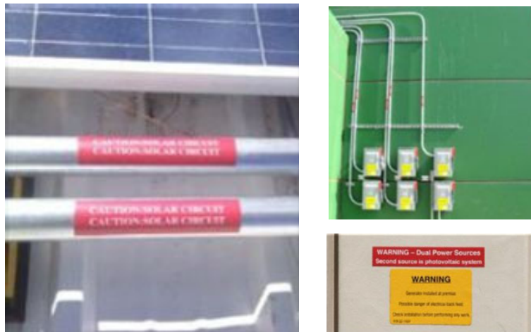
図 B.5.2-5 直流配線や接続箱等へのラベリング例 出所) Firefighter Safety and PV Course, UL
