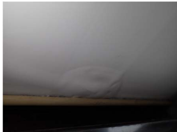
(d)バックシートの剥離 (a)図の褐色変部の裏面
