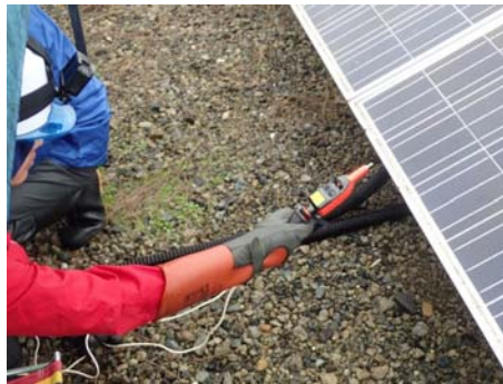
(c) 周辺の太陽電池モジュールフレームの検電
