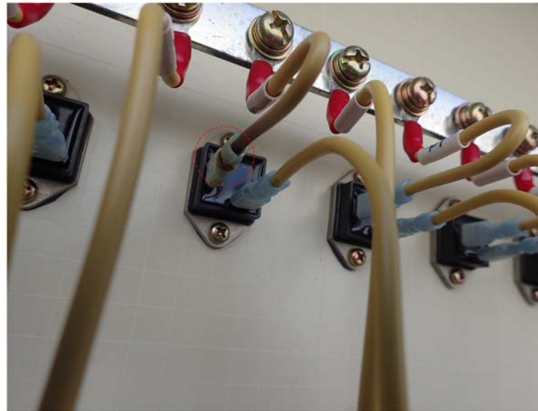
図 4.R3.4-3 接続箱#02 内部の様子 (ストリング#05 の BLD 接続部の変色)
