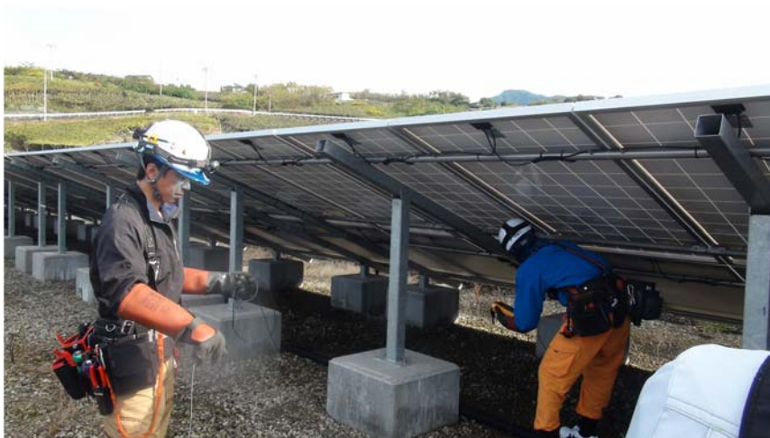
図 4.R3.6-10 モジュールフレームと接続箱内接地極の間の抵抗値を測定している様子
