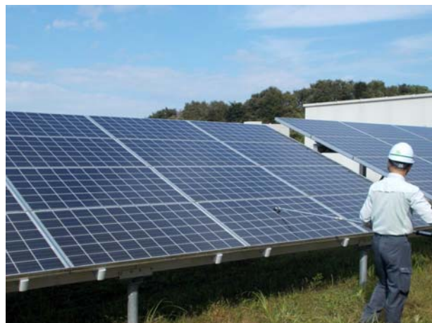
図 4.R2-19 ソラメンテ iS による BPC 短絡故障の検査
