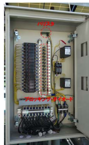
図 4.R3.8-1 接続箱#01の内部の様子
