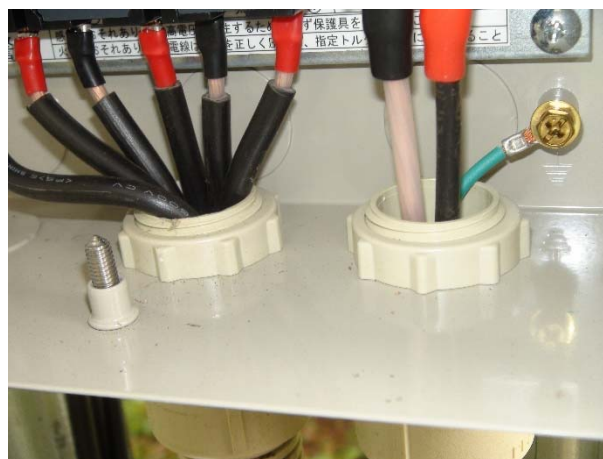
図 4.R3.5-2 接続箱下部の配線
