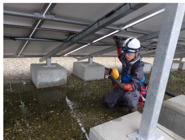
図 4.R3.6-5 モジュールフレームと接続箱内接地極との間の抵抗を測定している様子(接続箱 A)
