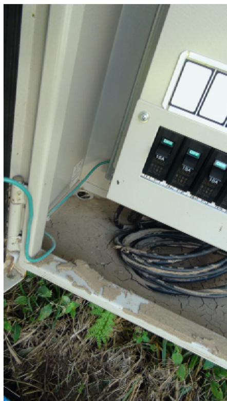
図 4.R3.3-5 端子台底部の貫通穴 (接続箱#07)
