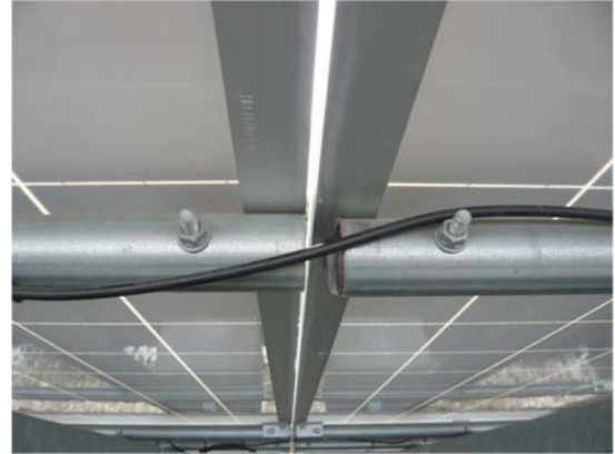
図 4.R3.6-19 接地線が接続されていない ストリング#08
