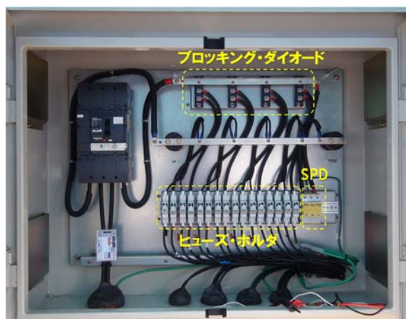
図 4.R3.6-1 接続箱(8 String用)内部の様子
