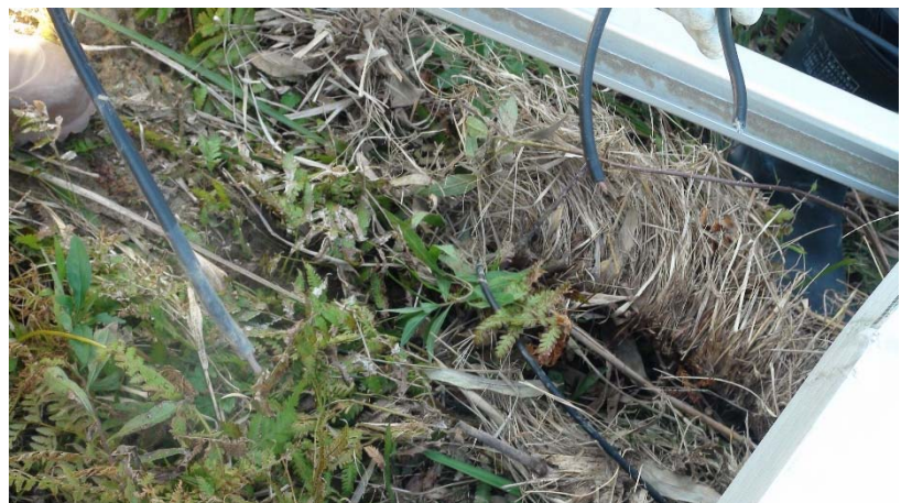
図 4.R3.3-22 絶縁処理がされていなかった ケーブル切断部(接続箱#02)
