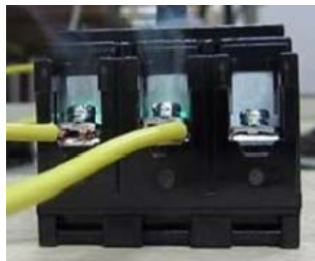
図 3.4-1 AC ブレーカ利用による事故例
