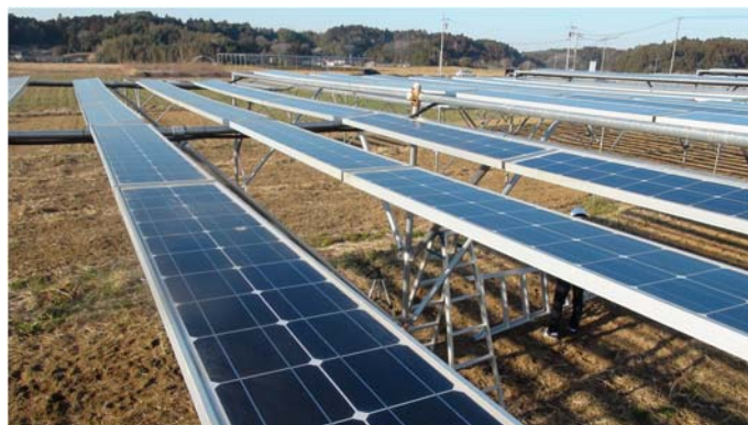
図 4.R3.11-9 汚れを除去したあとのモジュール表面
