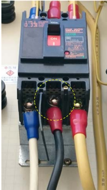
図 4.R3.4-2 接続箱#01 内部の様子 (開閉器二次側のケーブル接続)
