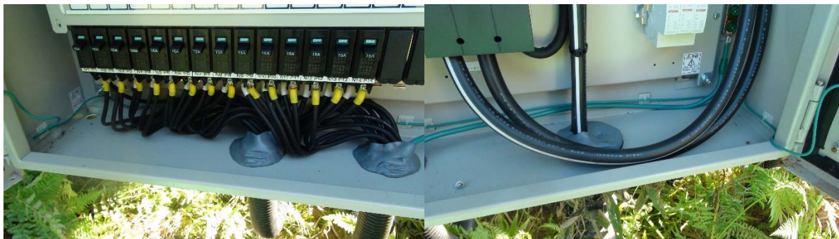
図 4.R3.3-23 「接続箱#01」の内部の様子
