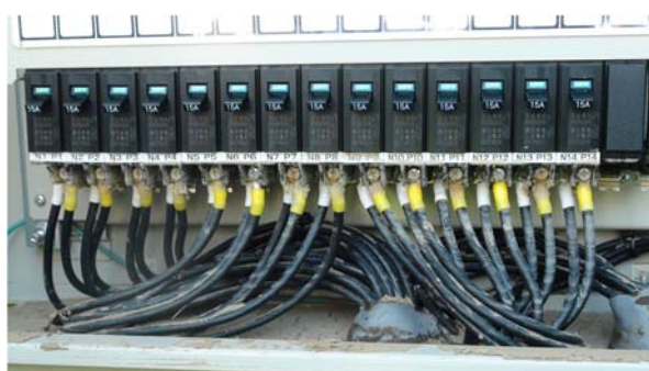
図 4.R3.3-4 端子台下部の汚れ(接続箱#07)
