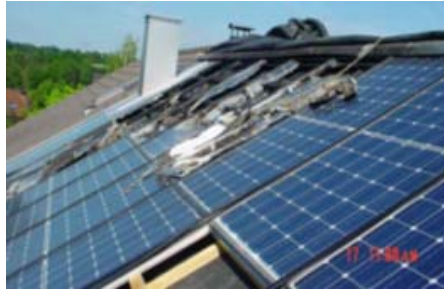
図 3.2.1-2 風による反復荷重の影響によるモジュールアーク事例
