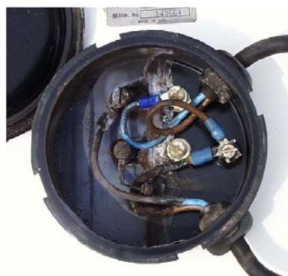
図 3.2.5-1 太陽電池モジュール端子箱内での腐食例
