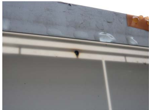
(b)横タブの接続部の導通不良に起因する褐色変
