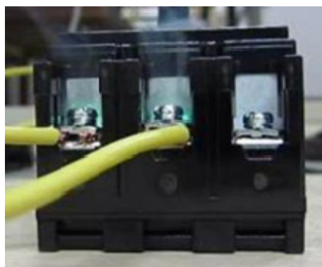
図 3.4-1 AC ブレーカ利用による事故例
