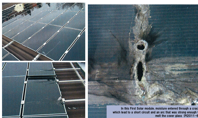
図 3.2.1-1 積雪荷重によるガラス割れによるモジュールアーク事例 (参考文献：Photon international 誌)
