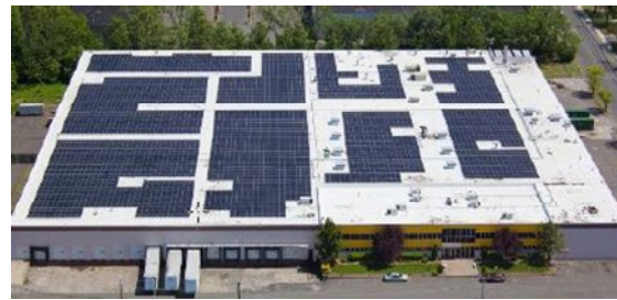
IFC2012に準拠したPV設置(商業用陸屋根)
