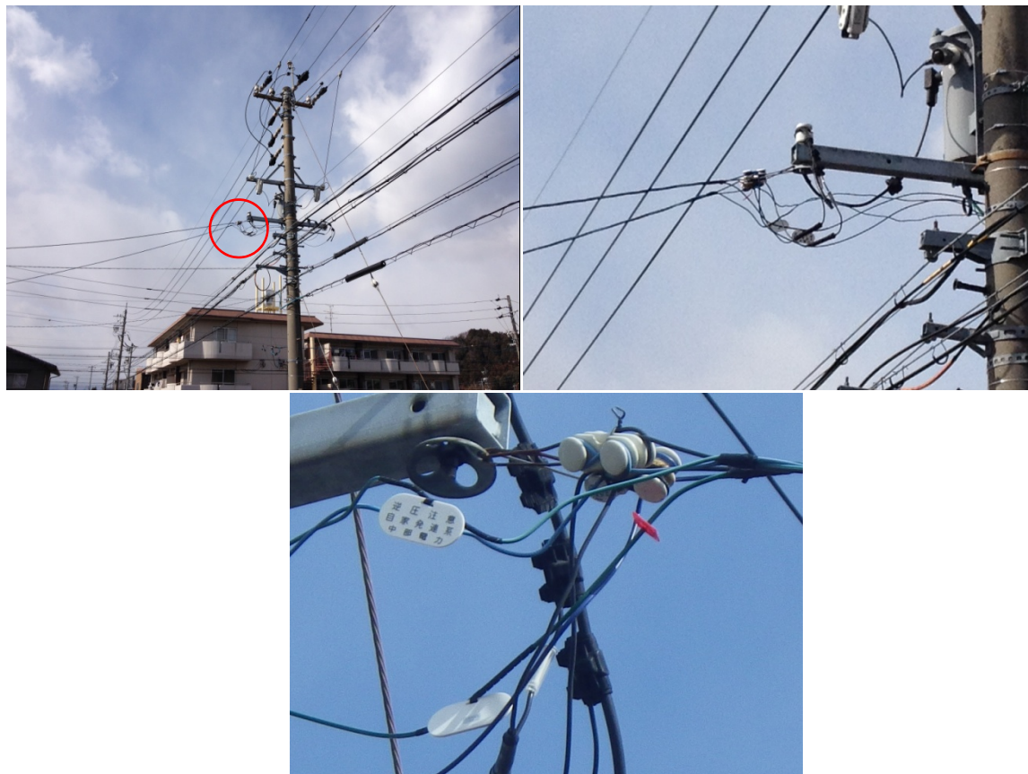
例 1 引込み線における目印の例 16
