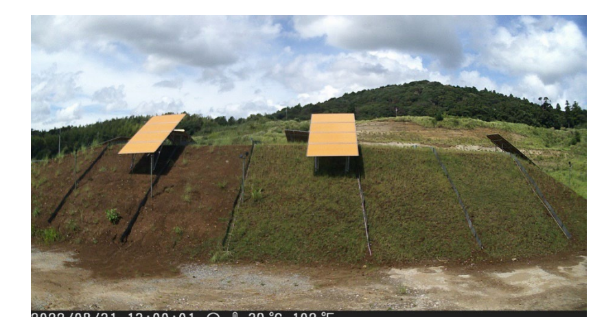
地盤侵食の実測調査
