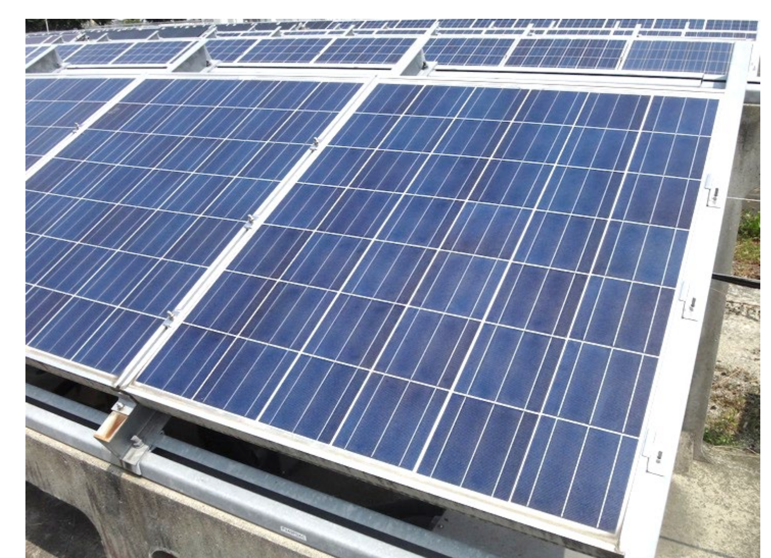
屋外曝露・TPO型モジュールの外観
