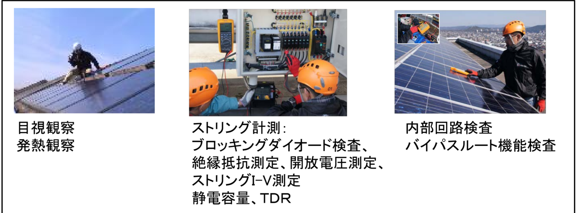
図 太陽光発電の保守点検技術
