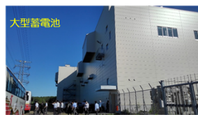
北海道電力・南早来変電所の大規模蓄電池 (大竹撮影)
