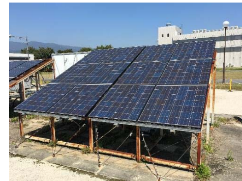
屋外設置モジュール・ストリング
