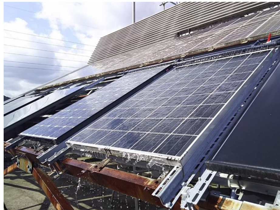
洗浄システムが動作している様子
