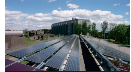
第3事業所 PVパビリオン, 屋上
