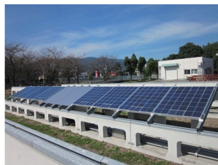
図 3. 屋外設置状態
