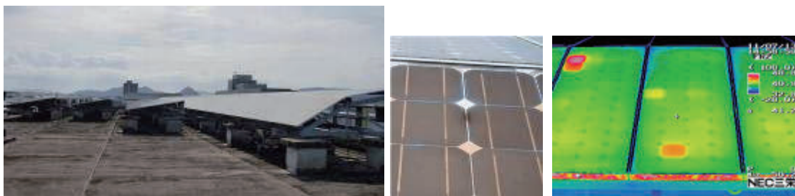
図 II-2-1-1. 産総研四国センターの曝露モジュール（左）黄変と端子箱裏の焦げ（中央） 発熱異常のモジュール（右）
