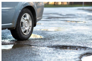
道路損傷の例
