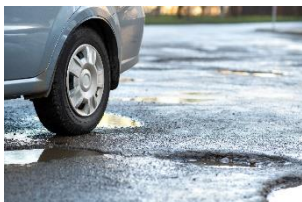
道路損傷の例
