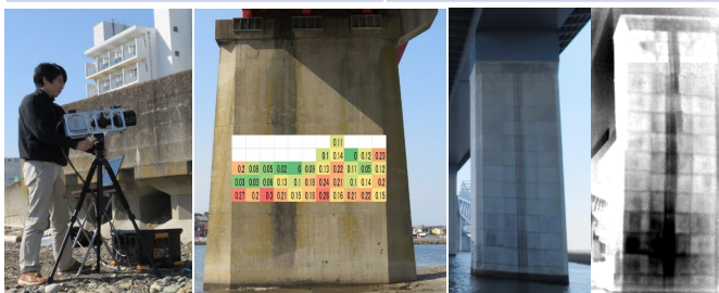
計測の様子 危険箇所の定量提示 劣化進行度合の可視化
