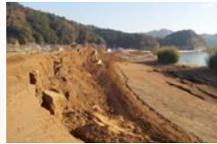
<2014年11月・由良川堤防の沈下> ・9月27日より施工中(延長約200m、高さ約50m) ・11月21日夕方～22日朝、延長約70mに渡り最大6m沈下
