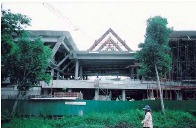
Fig. 17 ทางเข้าอาคารที่เป็นโครงสร้างเปิดโล่ง
