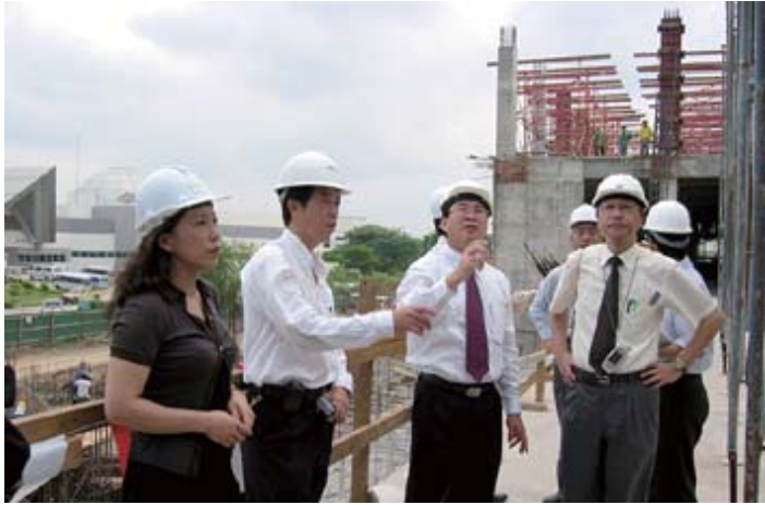
図 18 建設中の新庁舎の説明を 受ける調査団。 中央で説明しているのは NIMT のソムサク氏。
