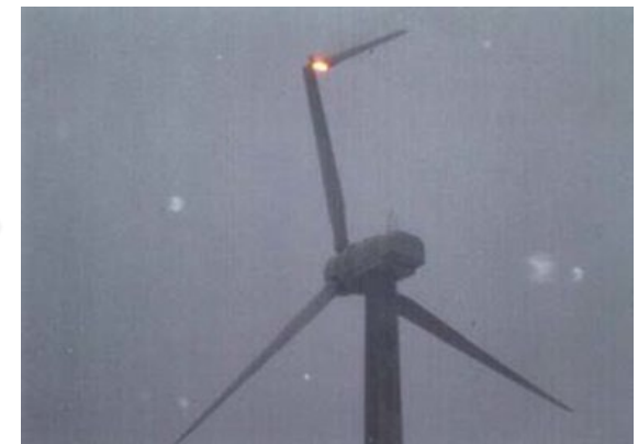
雷によるブレード折損
