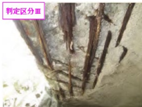
床版鉄筋露出 ※床版:橋の裏側
