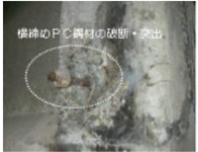
横締めPC鋼材の突出事例
