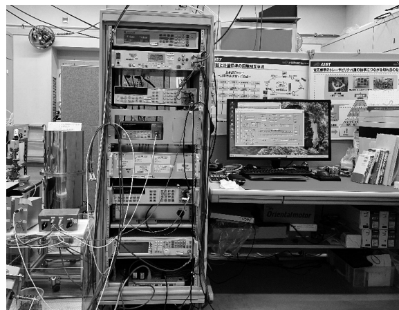
図 7 NMIJ が維持管理する現行の直流電圧標準システム (PJVS システム) の外観写真
