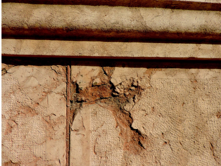
鉄筋腐食に伴う膨張で、クラック発生
