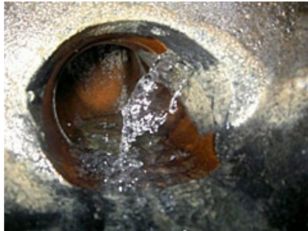
下水道の雨天時浸入水
