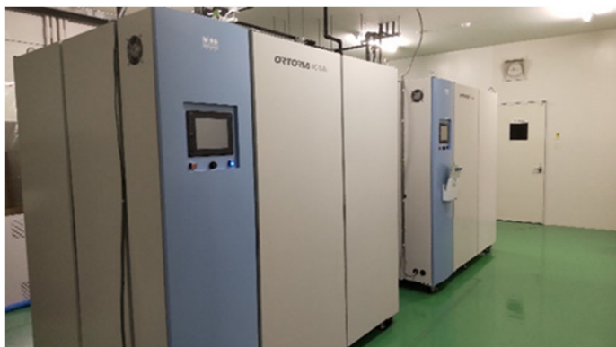
新設した超純水製造装置
