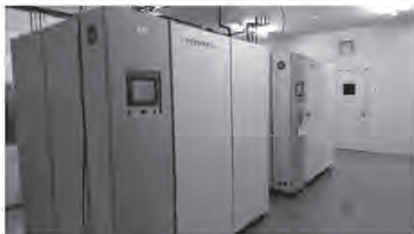
新設した超純水製造装置
