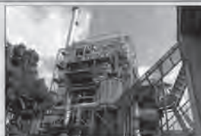
県内で稼働中のバイオマスボイラー
