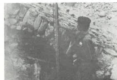
堤防の決壊調査
