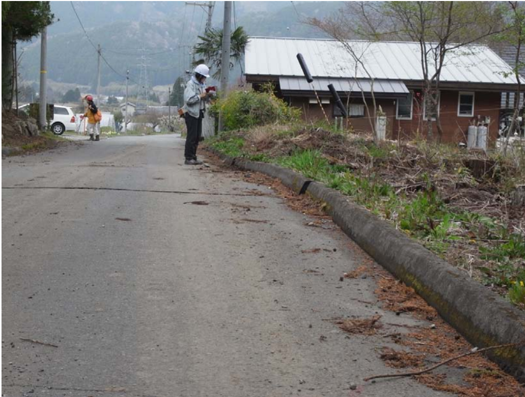
写真 3 : 遠野町入遠野天王の付近 (37° 3.46' N, 140° 42.41' E) 幅約 30m の断層帯によつて、道路が南西下がりに変形. 4 条の亀裂による左ずれ・水平伸張はそれぞれ約 10cm.
