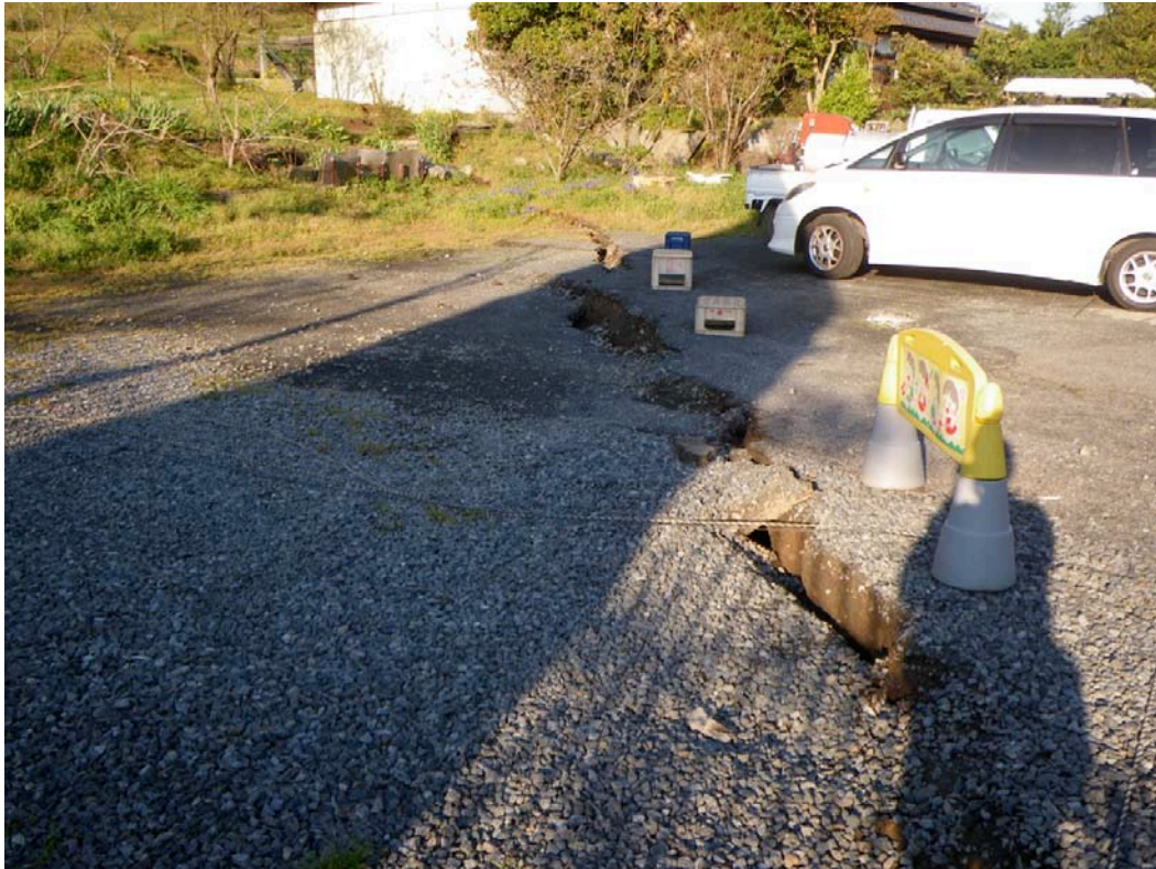
写真 13 : 常磐藤原町別所の付近 (36° 59.87' N, 140° 49.17' E)
