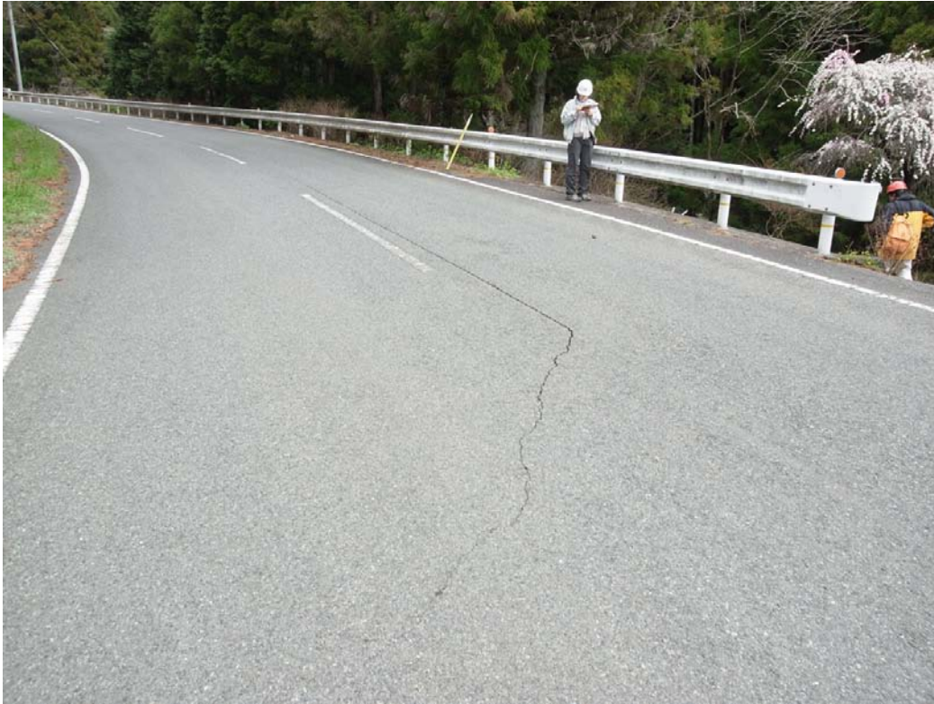
写真1：遠野町入遠野白鳥の北方約0.2km (37° 3.86' N, 140° 41.21' E) わずかな左横ずれと南北伸張を伴う断層が道路を横断. N31° E方向のガードレールが2cm引き延ばされた.
