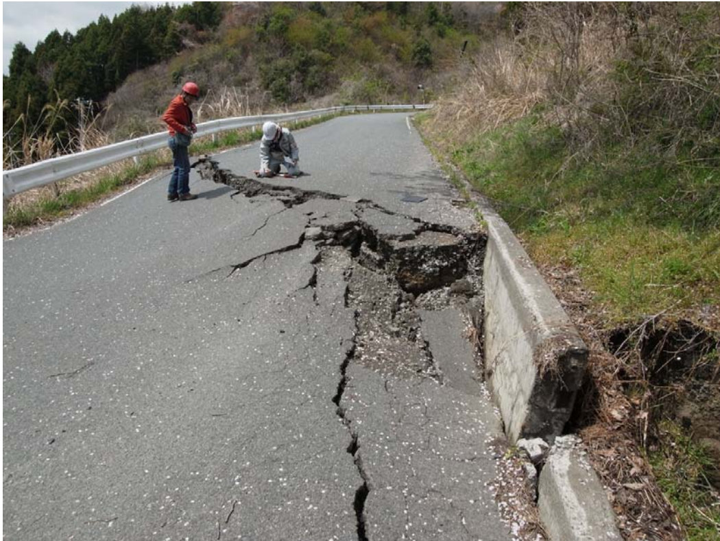
写真 11 : 常磐藤原町阿良田の北東 0.3km ( 37^{\circ} 0.40' N , 140^{\circ} 48.40' E ) 副断層 1. 断層の走向は NE-SW で、変位ベクトルの方位は SSE. このため、右ずれ成分が顕著に見られる.
