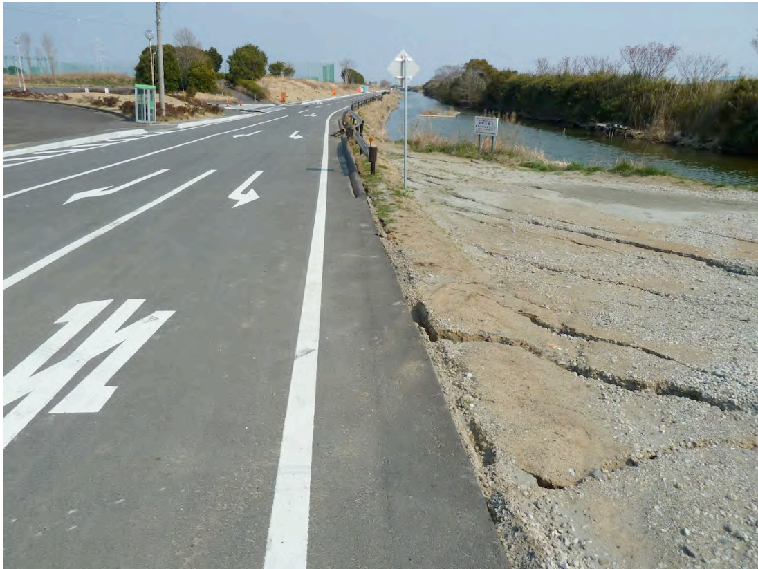
C 地点より前川方向を望む．地盤が前川方向に移動している．
