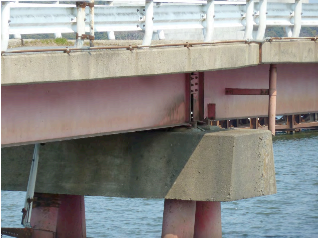
桁の固定部分. 落橋防止装置は付いていない.
