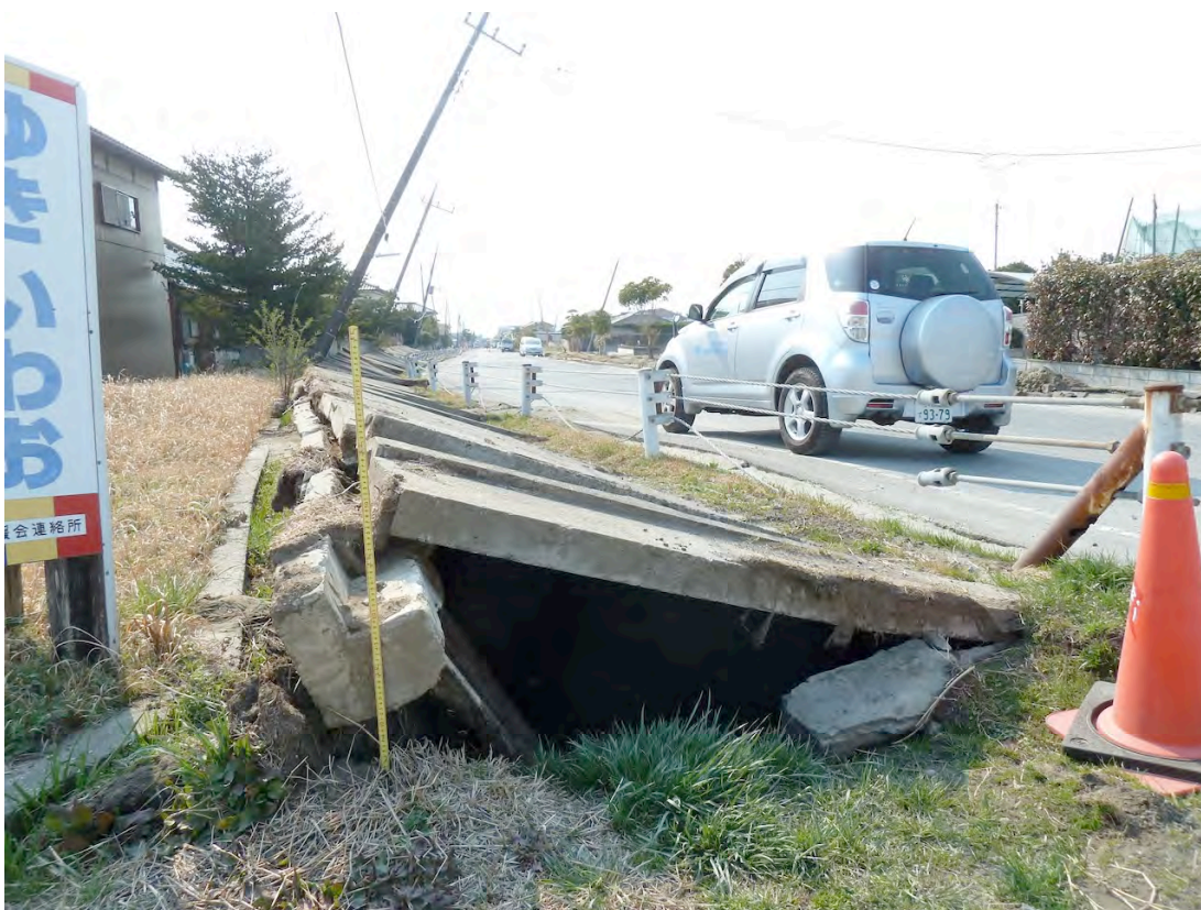
左方向からの液状化地盤の押出し
