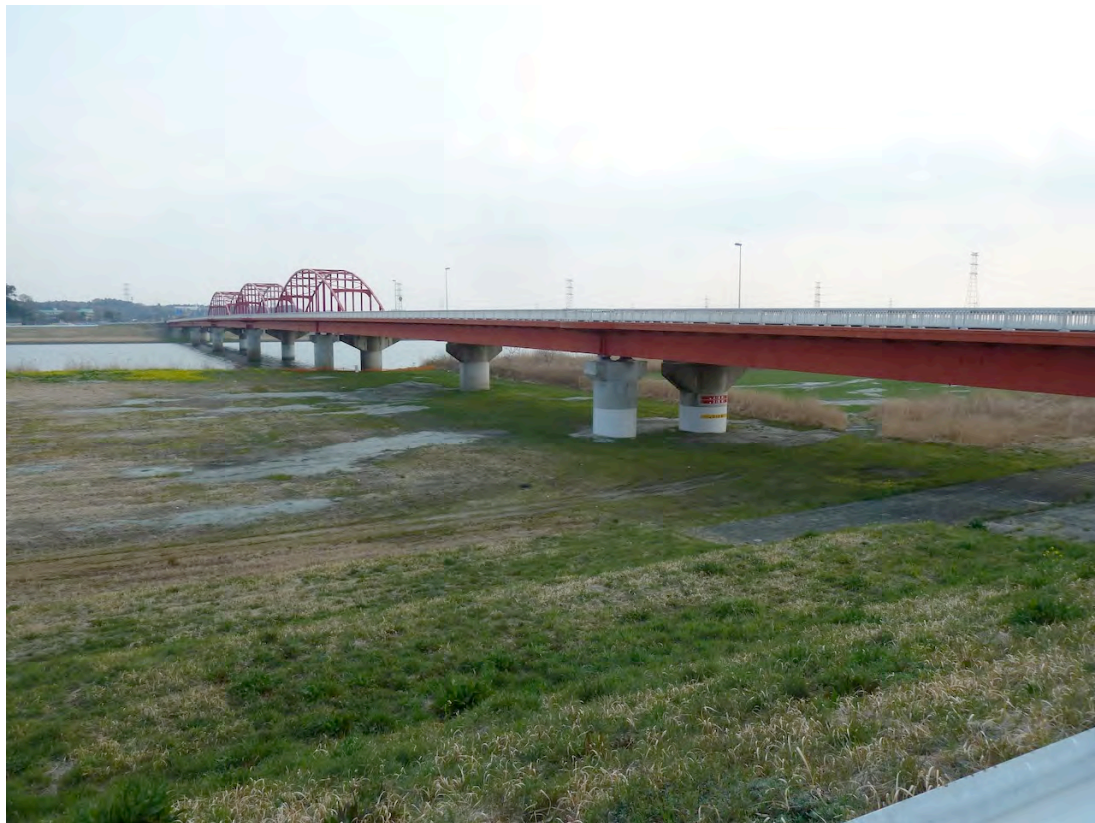
神崎大橋を茨城側より望む。河原に噴砂跡が見られる。
