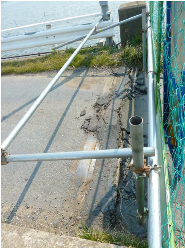
堤防にはやや変形があるが、アバット部に大きな相対変位はない。落橋は橋脚の流動もしくは転倒が原因と思われる。
