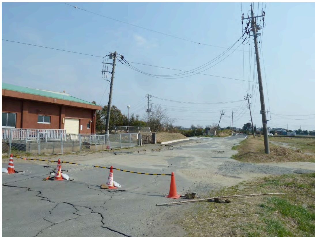
A から地盤変状部を望む。道路の先の水門と地盤に 80cm 程の段差が出来ていた。
