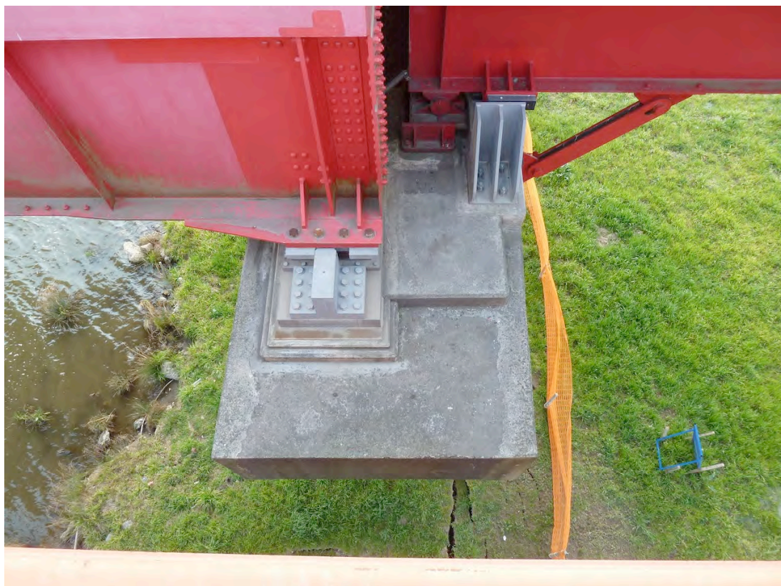
アーチ部と連続橋部の継ぎ目。橋脚が左方向に動いたことを示唆。
