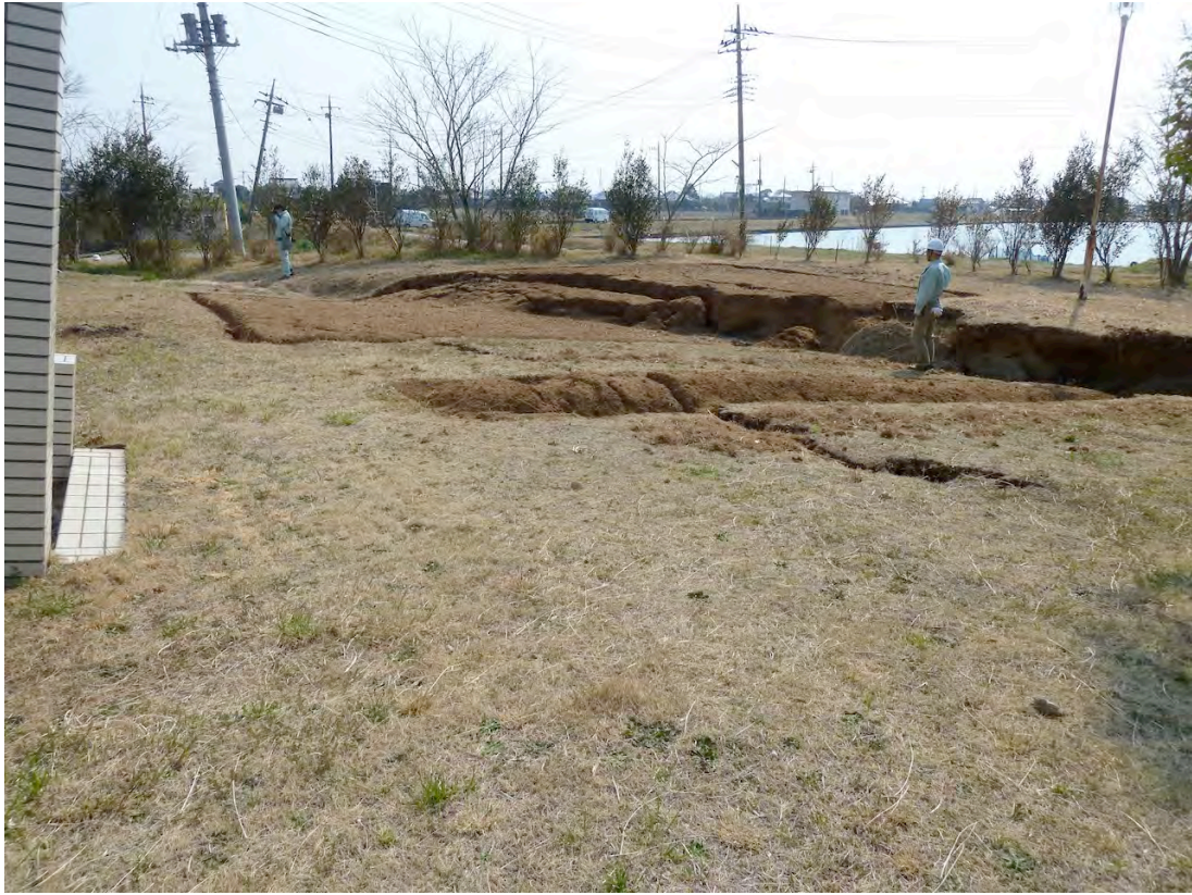
B 地点よりプール建物周囲の地盤が池（写真右）および前川側（写真左奥）に移動．運動公園全体が盛土と思われる．
