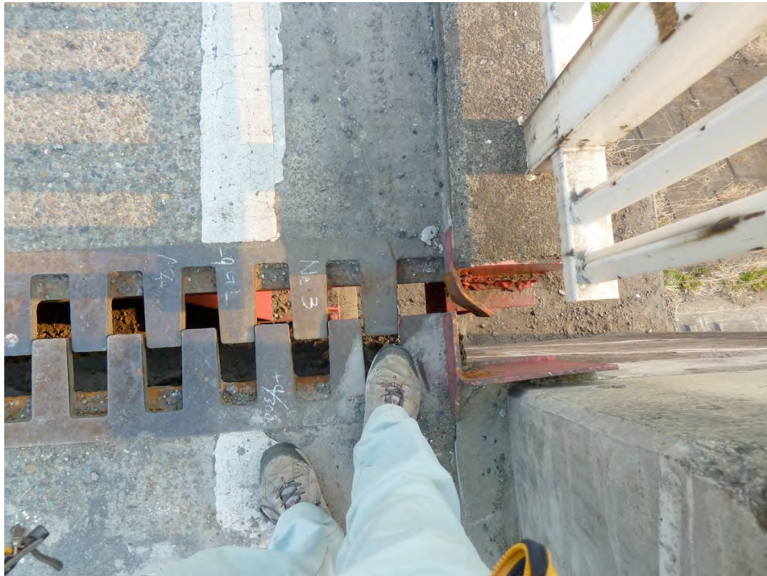
伸縮継手部が目一杯開いている。横の鋼板は地震時に衝突で曲がったか。
