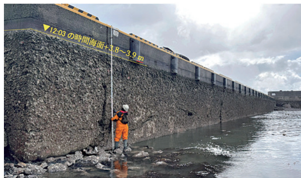
写真1 海岸の隆起調査。鹿磯漁港の防潮堤に固着した生物遺骸が示す隆起の様子。人が持っている標尺の長さは5m。(地質調査総合センター公式HPより)
