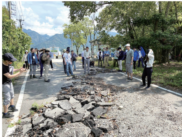
写真9 2022年9月18日に台湾東部で発生した地震（マグニチュード6.9）によって生じた道路の亀裂被害。
