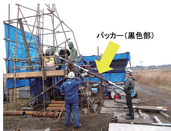
図 3 上北ボーリング掘削現場。揚水のため帯水層の上位にパッカー（黒色部）を設置する準備作業を行っているところ。パッカーはゴム製で空気圧により膨張し、ボーリング孔を閉塞する。
