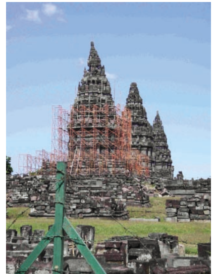
写真1 プランバナン遺跡における2006年ジャワ島中部地震の被害。
