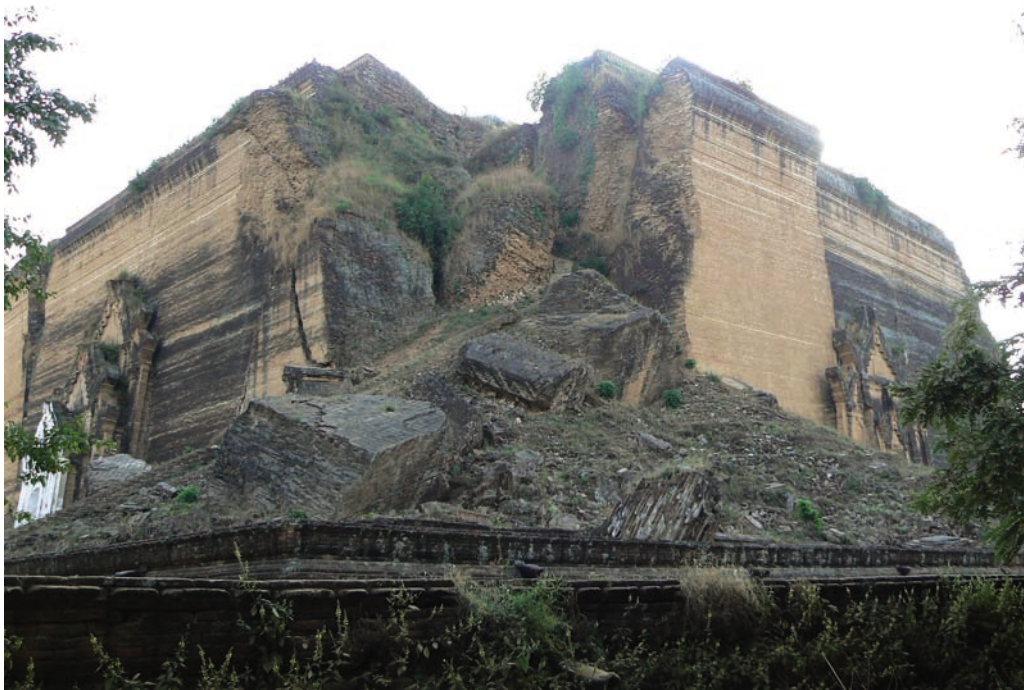
写真 2 1839 年と 1956 年の地震により大きな被害を受けたミンゲンパゴダ。至る所に亀裂が入っているが、特にパゴダの北東部が大きく崩壊している。
