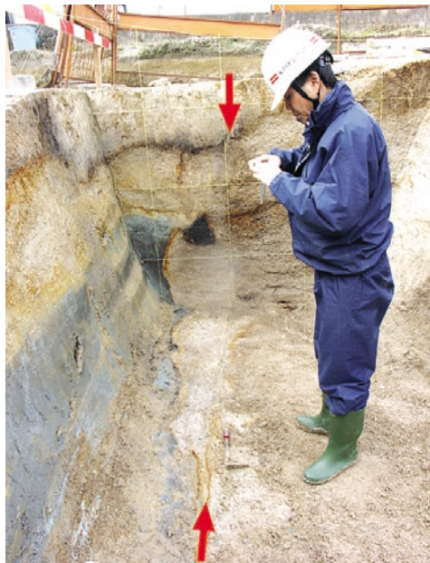
断面22と底盤に現れている断層。奥の壁面(断面22)に設置してあるグリッドは50cm四方。
