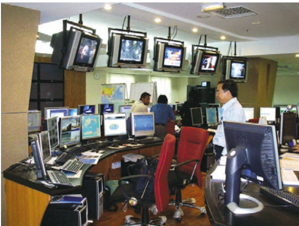
写真1 マレーシア気象庁の津波警報システム
