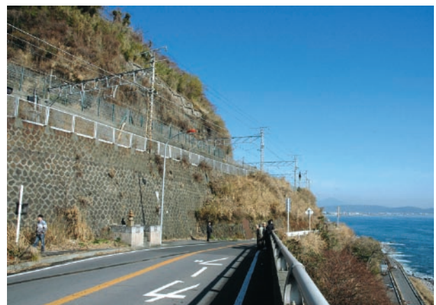
東海道線根府川駅そばの斜面崩壊跡。道路左側に慰霊碑がある。
