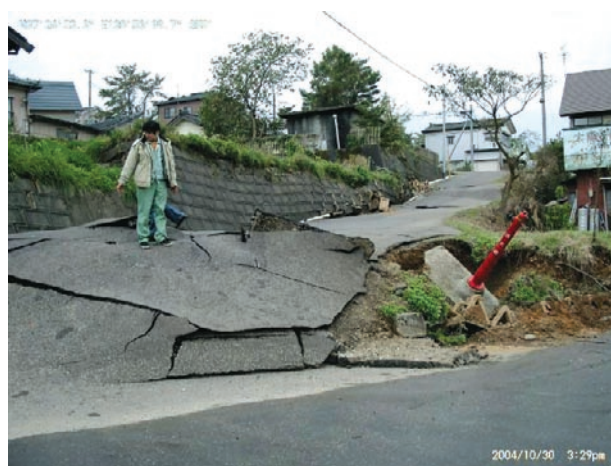
写真7 住宅地の地すべりによる路面の変形。（長岡市乙吉町）
