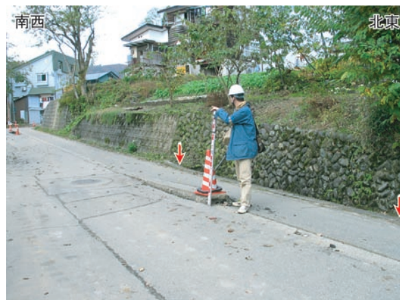
写真1 旧広神村小平尾集落内の消雪パイプの圧縮変形
