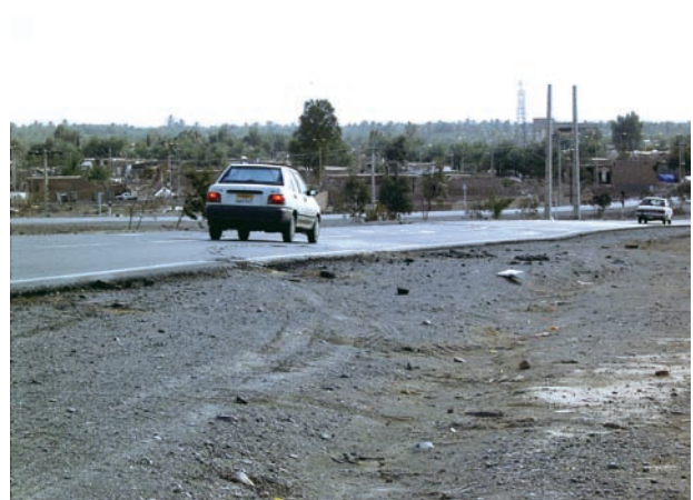
写真7 ハイウェイに現れた地表亀裂 舗装道路の変形から亀裂間での落ち込みが認められる（越後氏撮影）
