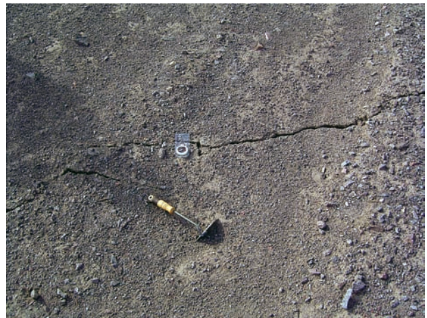
写真5 北部セグメントの開口亀裂（越後氏撮影）
