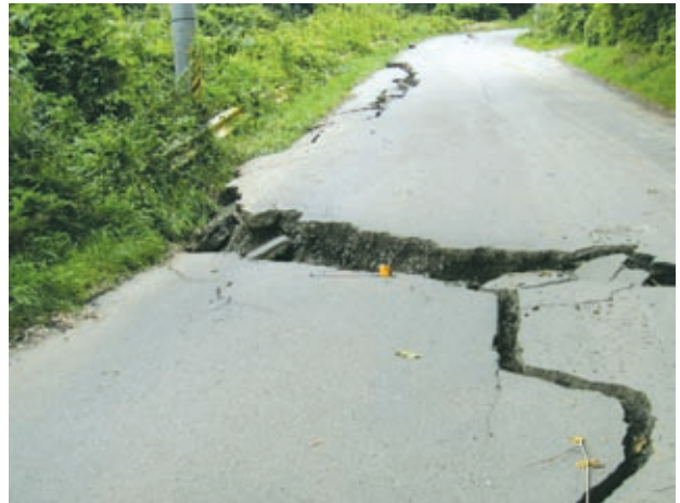
高寺南方における路面の亀裂
