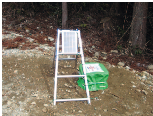
写真 3 設置完了後の写真。ソーラーパネルは脚立に取り付けた。収録装置を格納したケースは防水カバーで覆っている。地震計は脚立の真下に埋設されている。
