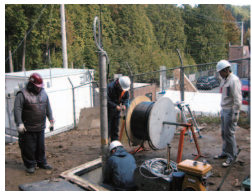
写真 1 孔底地震観測装置（株式会社ミットヨ製）の外観。円筒形のステンレス容器の中に地震計と傾斜計が納められています。写真は安濃の孔 2 に設置する直前に撮影したものです。左側に写っている白い建物は観測小屋です。
